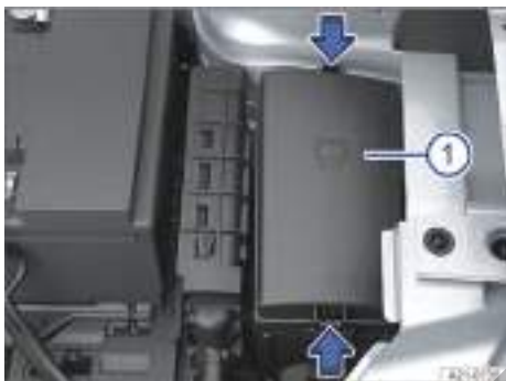
Fig. 151 En el vano motor: caja de fusibles.
